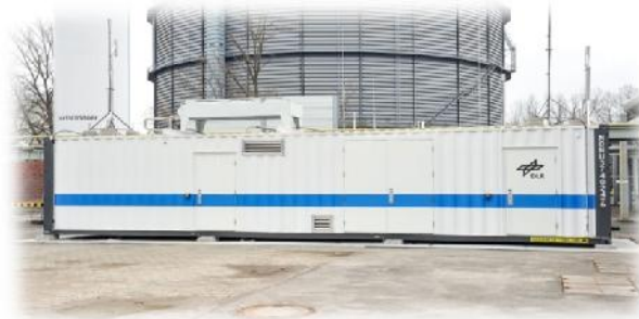
50 kW PEM Electrolyzer
